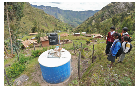
Im Rahmen des Projekts SABA wurde eine Wasserchlorierungsanlage installiert. Siusa, Distrikt San Salvador, Region Cusco.
